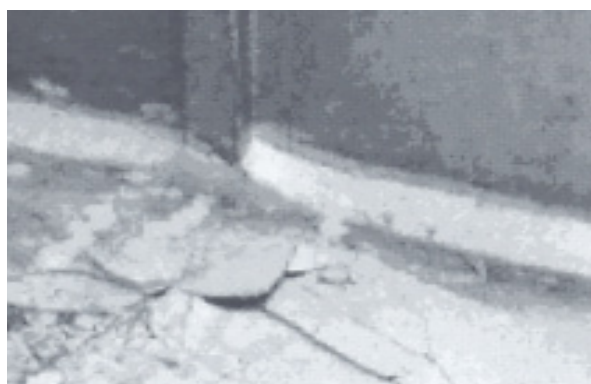
Fig. 5: Pardoselile din congelatoare sunt susceptibile de distrugere din cauza stresului, ca alcătuirea de gheață prin trecerea repetată de la rece ( -40^{\circ}\text{C} ) la temperatura ambientală.
