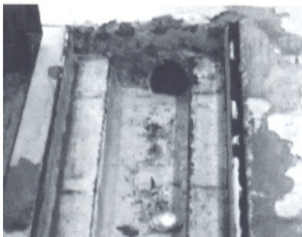
Fig. 4: Scurgerile cu eliminările protejate ilustrează clar cum distrug înalte zone de folosire, cum sunt marginile ridicate ale pardoselilor care pot rezulta nu numai din contaminarea potențială a produsului cu materialele pardoselii, ci și din problemele ce apar din țevile blocate.
